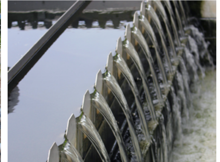
Ablauf Nachklärbecken (Foto: LFKW)
